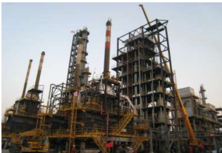
图 4. 20 万吨/年润滑油基础油加氢异构脱蜡装置
