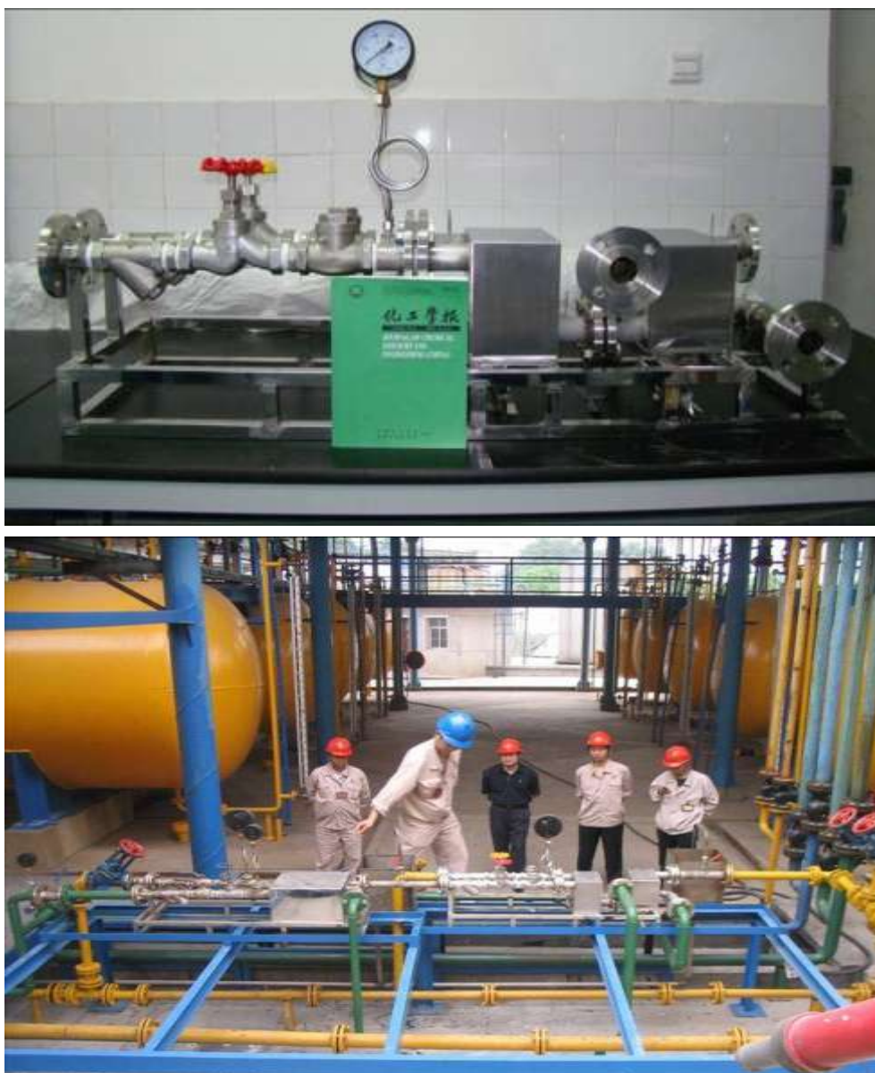
产量为 10 万吨/年用于磷酸二氢铵生产的微化工系统
