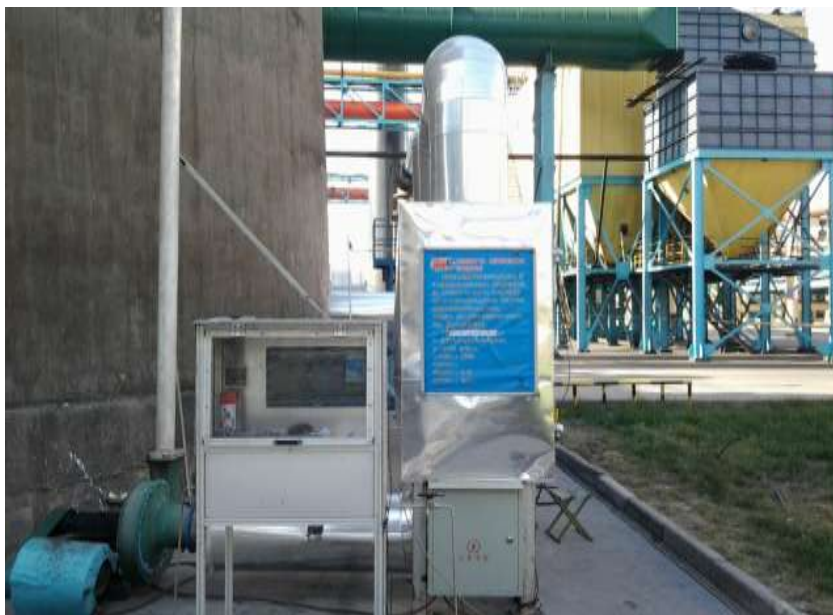
焦炉烟气脱硝工业侧线装置
