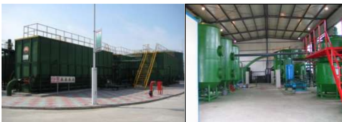
注聚污水回用处理装置稠油废水处理工业化装置
