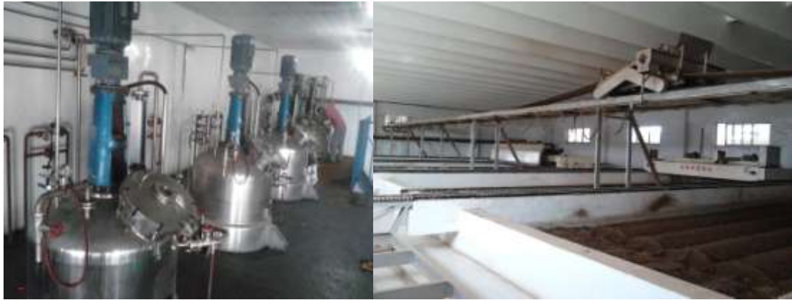
液体发酵罐固体发酵池
