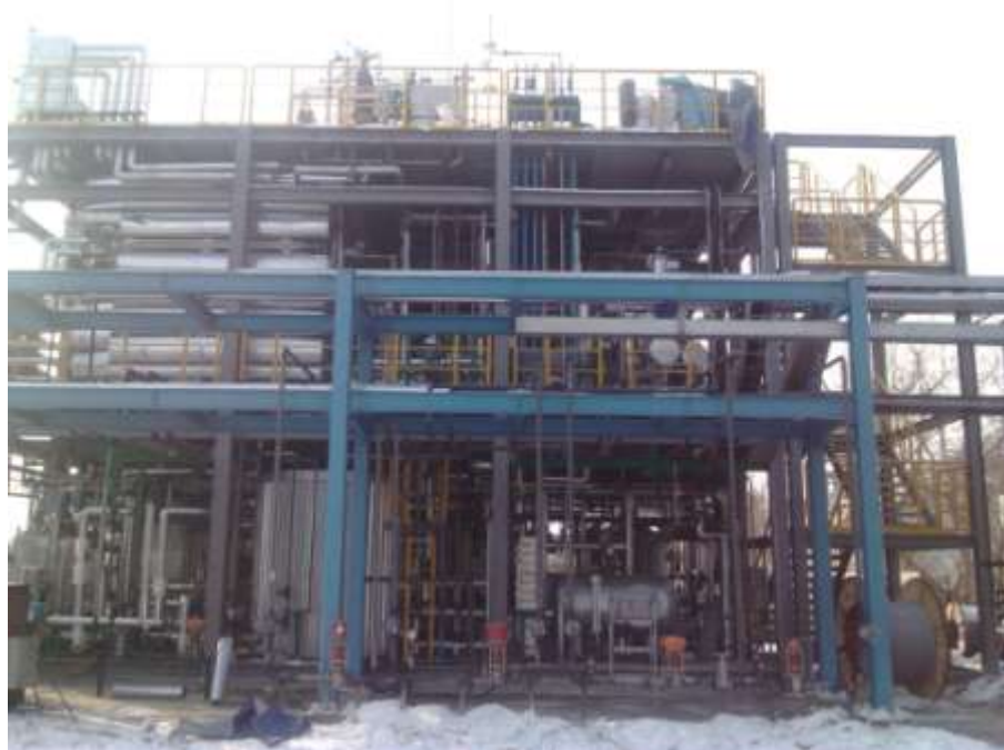
CWA0 处理高浓度有机废水工业化装置
