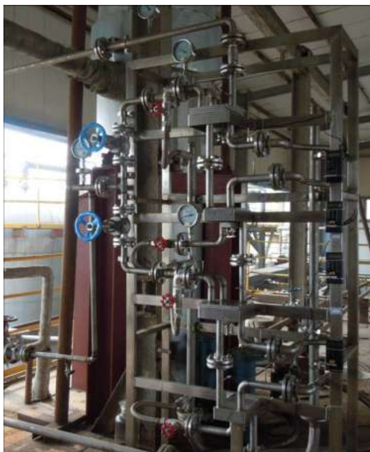
产量为 1 万吨/年用于石油磺酸盐生产的微化工系统
