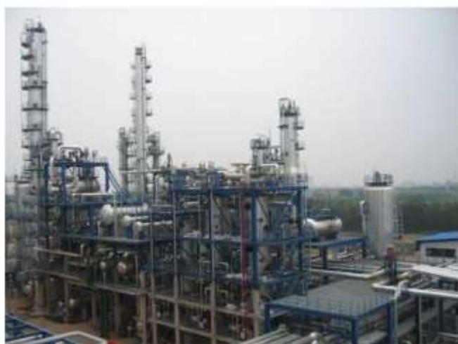
山东华星石化 8 万吨/年乙苯装置
