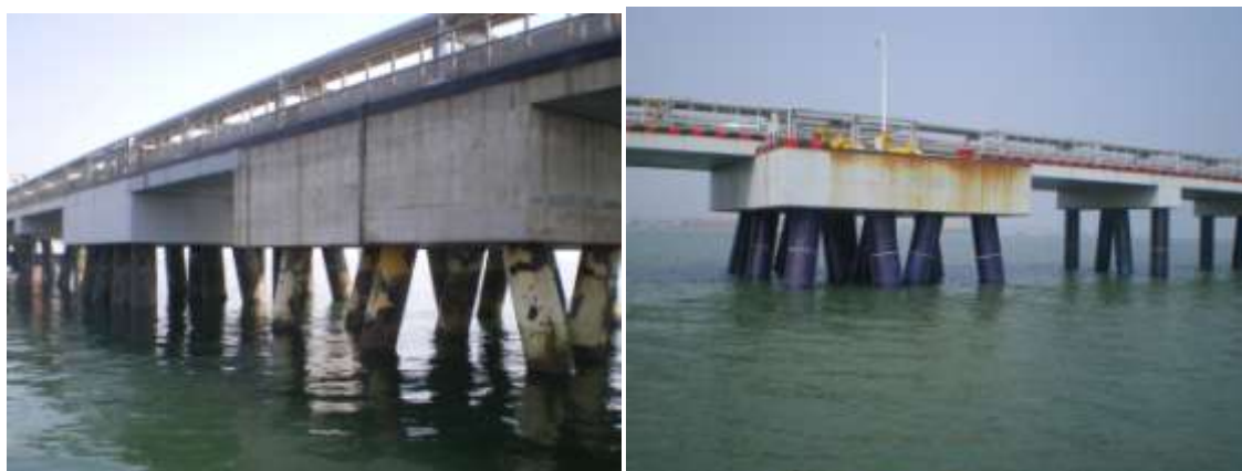
青岛港复层包覆防腐技术修复前后对比
