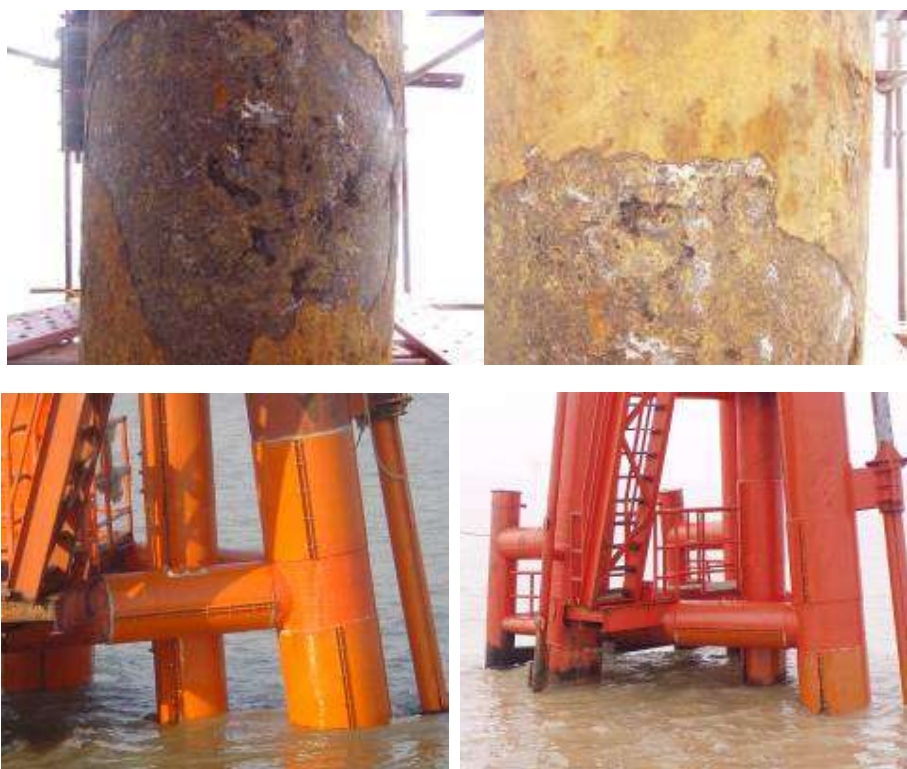
胜利油田平台复层包覆防腐技术修复前后对比
